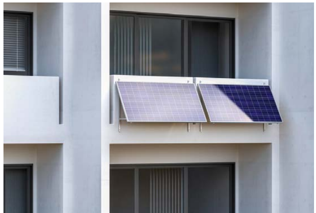
Für die Energiewende unverzichtbar, aber meldepflichtig: Photovoltaikanlagen in allen Größen
